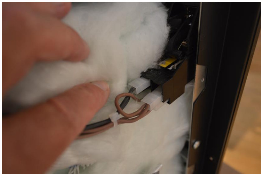
Door switch left and right side/ Interruttore porta e destra e sinistra
